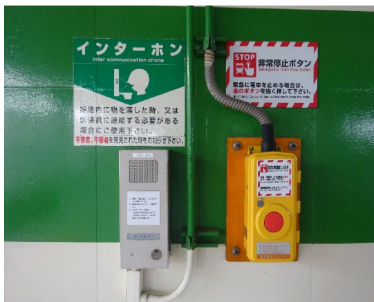
各駅ホームの非常停止ボタンとインターホン
