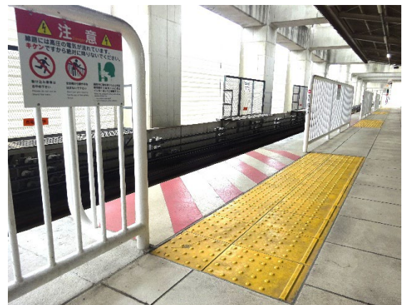
ホーム乗降口の安全設備(丸山駅上り)
