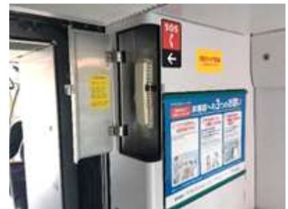
電車内インターホン
