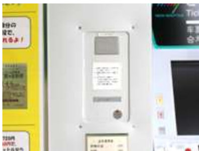
駅務室インターホン
